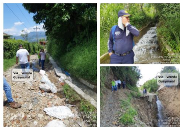
Figura 7. Afectaciones observadas a la vía a la vereda Guaymaral, municipio de Amagá.
